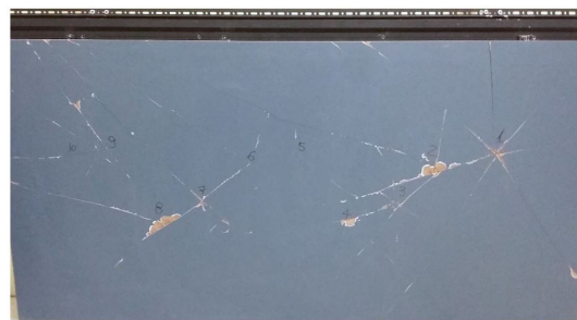
Figura 12. Resultados de trincas, rupturas e afundamentos obtidos no ensaio.
