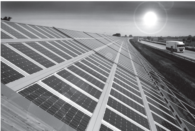
Figura 10. Painel de revestimentos porcelânicos equipado com células fotovoltaicas.
