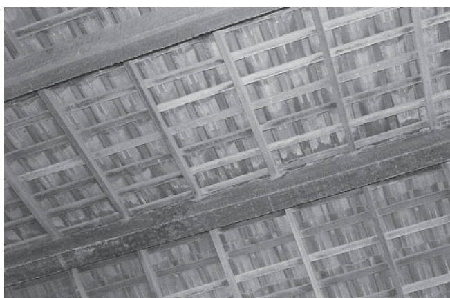
Figura 2. Telhas com fluorescência.
