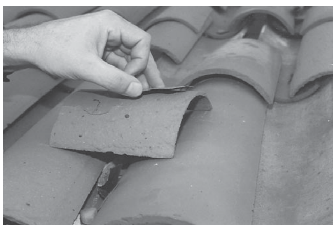
Figura 3. Telhas com criptorescência 5 .
