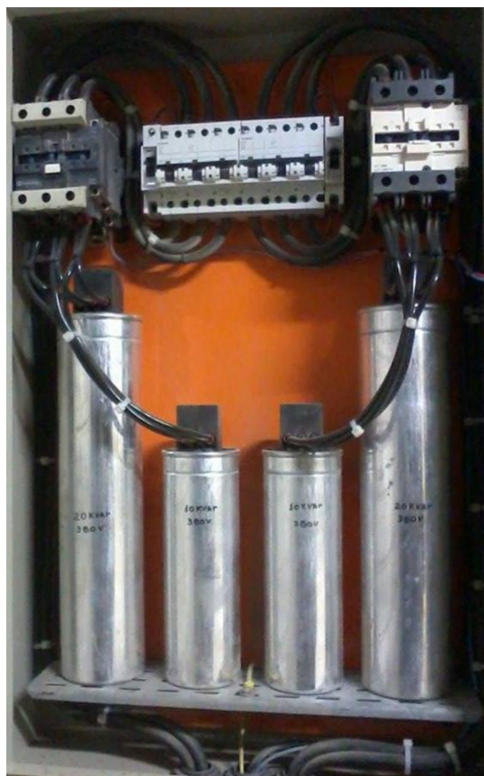
Figura 7. Banco de capacitores. Fonte: Autor.
