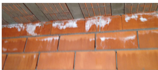
Figura 1. Parede com formação de eflorescência.
